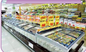
フロン不使用冷ケース
