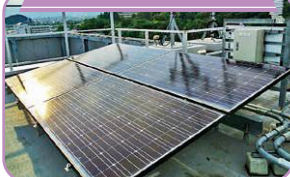
屋上の太陽光パネル
